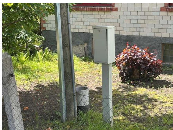
Elektrības sadalnes skapis
